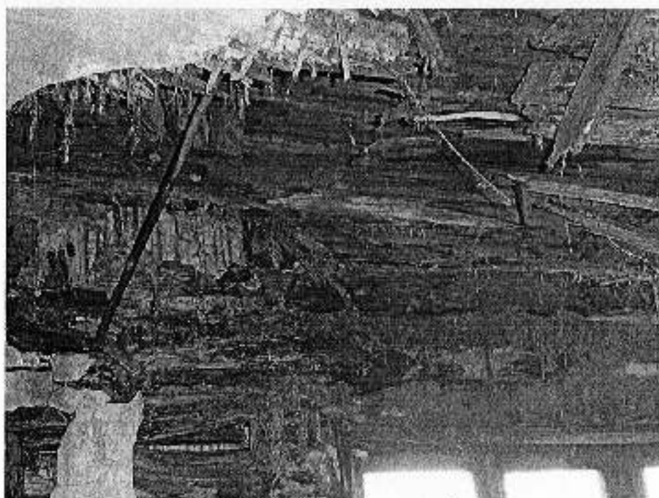
Fot. 11. Widok zdewastowanego stropu.
