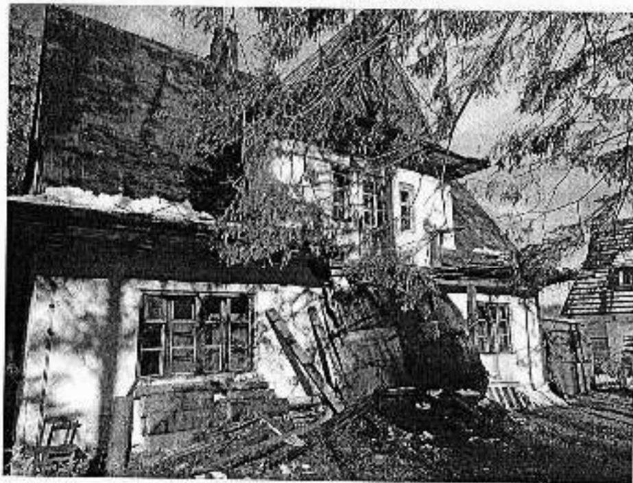
Fot. 2. Ogólny widok budynku - drewniany ganek, teras oraz ściana zniszczone przez drzewo przewrócone wiatrem.
