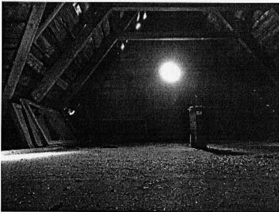
Fot. 9. Konstrukcja dachu była remontowana przed kilkudziesięciu laty.
