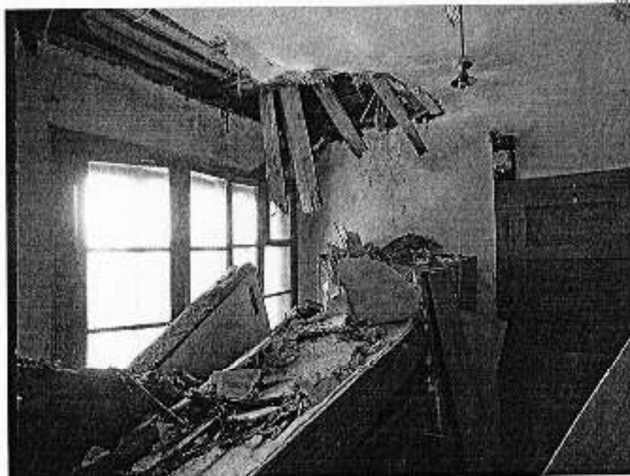
Fot. 4. Widok wnętrza – stropy zawalone w wyniku postępującej korozji drewna
